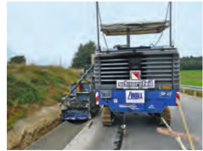
L3098 Schmal Beerbach (HE) Mise en œuvre d'une cunette en béton d'accotement derrière la bande dérasée en béton achevée
