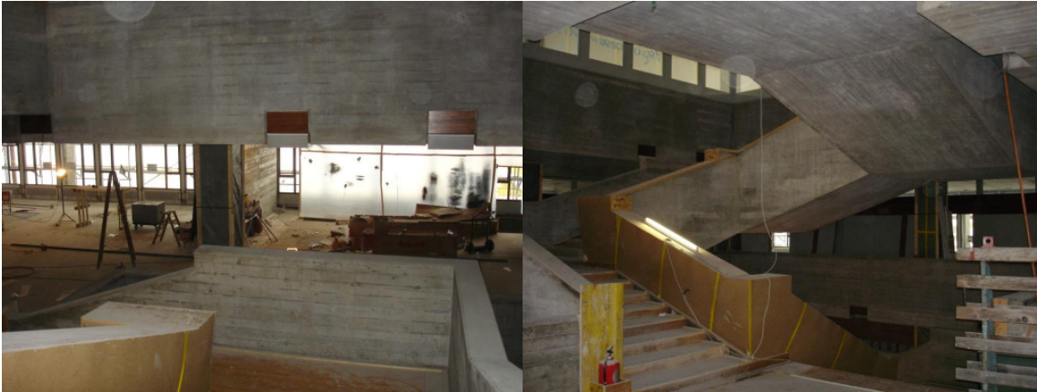
Abbildung 23: Verstärkende Massnahmen betreffend Erdbbensicherheit (links) und sichtlich guter Zustand der Original-Treppe (rechts)
