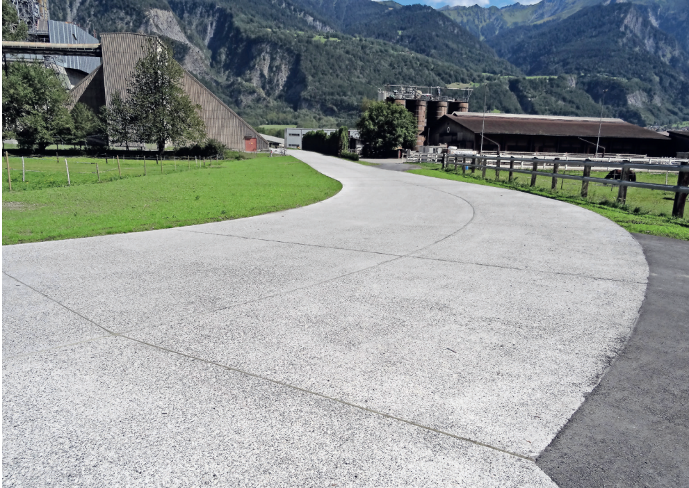
1 | Untervaz, Erschliessung Wingertli, Gesteinskörnung 11 mm (maschineller Einbau). 1 | Untervaz, route de desserte de Wingertli, granulat 11 mm (pose mécanique).
