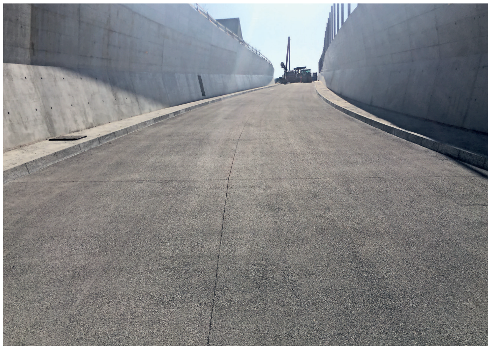
2 | A4-Zubringer-Tunnel, Bickwil, Gesteinskörnung 11 mm (maschinelles Einbau). 2 | Tunnel d'accès à l'autoroute A4 près de Bickwil, granulats 11 mm (pose mécanique).
