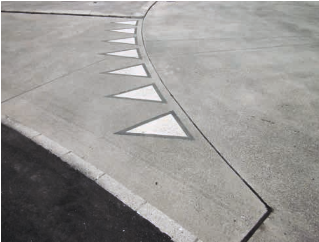
Surface de béton lavé un an après la mise en service de l'ouvrage
