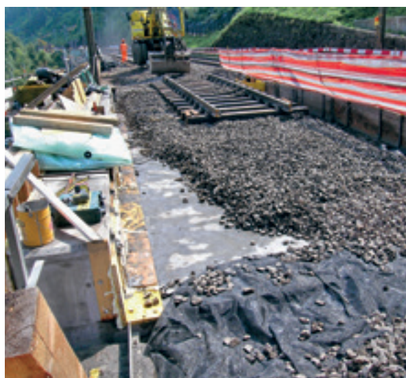
Fig. 3 Mise en place de ballast, puis de rails sur traverses, sur une couche d'étanchéité de BFUP. A gauche : coffrage négatif pour une couche de BFUP en bordure
