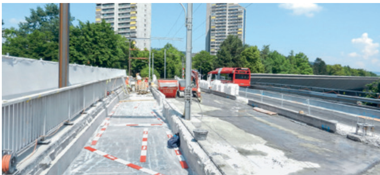
Fig. 12 Vue sur la moitié de la route prête à être recouverte de BFUP
