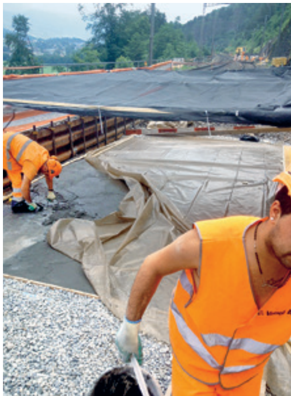
Fig. 2 Protection du BFUP contre le soleil, immédiatement après la mise en place, au moyen d'un couvert
