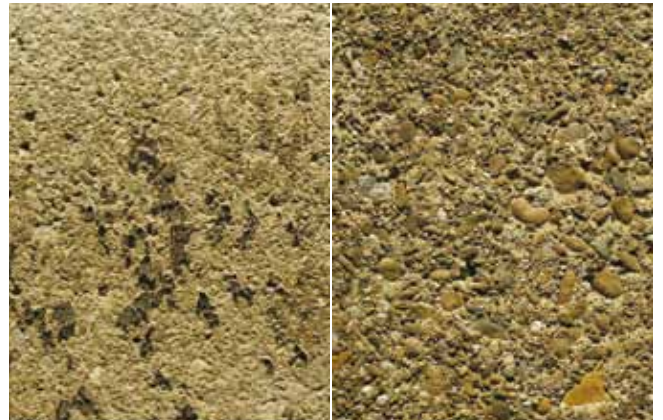
Abbildung 15: Vergleich ungereinigte (links) und gereinigte (rechts) Oberfläche (Betonwürfel B-OPC nach zweijähriger Auslagerung, erste Auslagerung)
