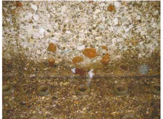
Abbildung 1: Typische Betonerosion an Wand und Düsenboden einer ARA (Bild: Peter Lehmann)
