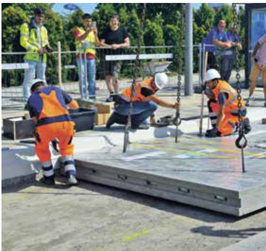
Verlegung der zweiten Fertigteilplatte am Schacht mithilfe des klassischen Verlegesystems (Stahlseile und Schwerlastanker)
