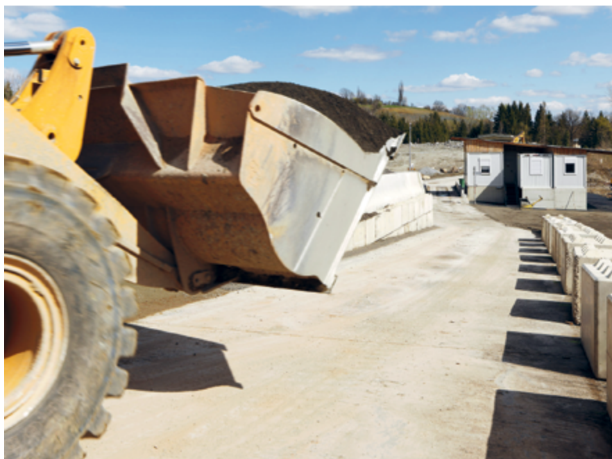
Le tronçon en béton compacté soumis à une forte sollicitation du trafic de poids lourds
