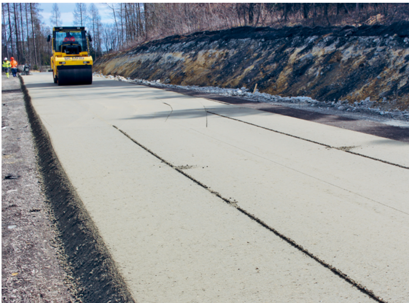
Post-compactage du béton à l'aide d'un rouleau lisse : les bandes de béton au premier plan seront ensuite lissées par post-compactage.
