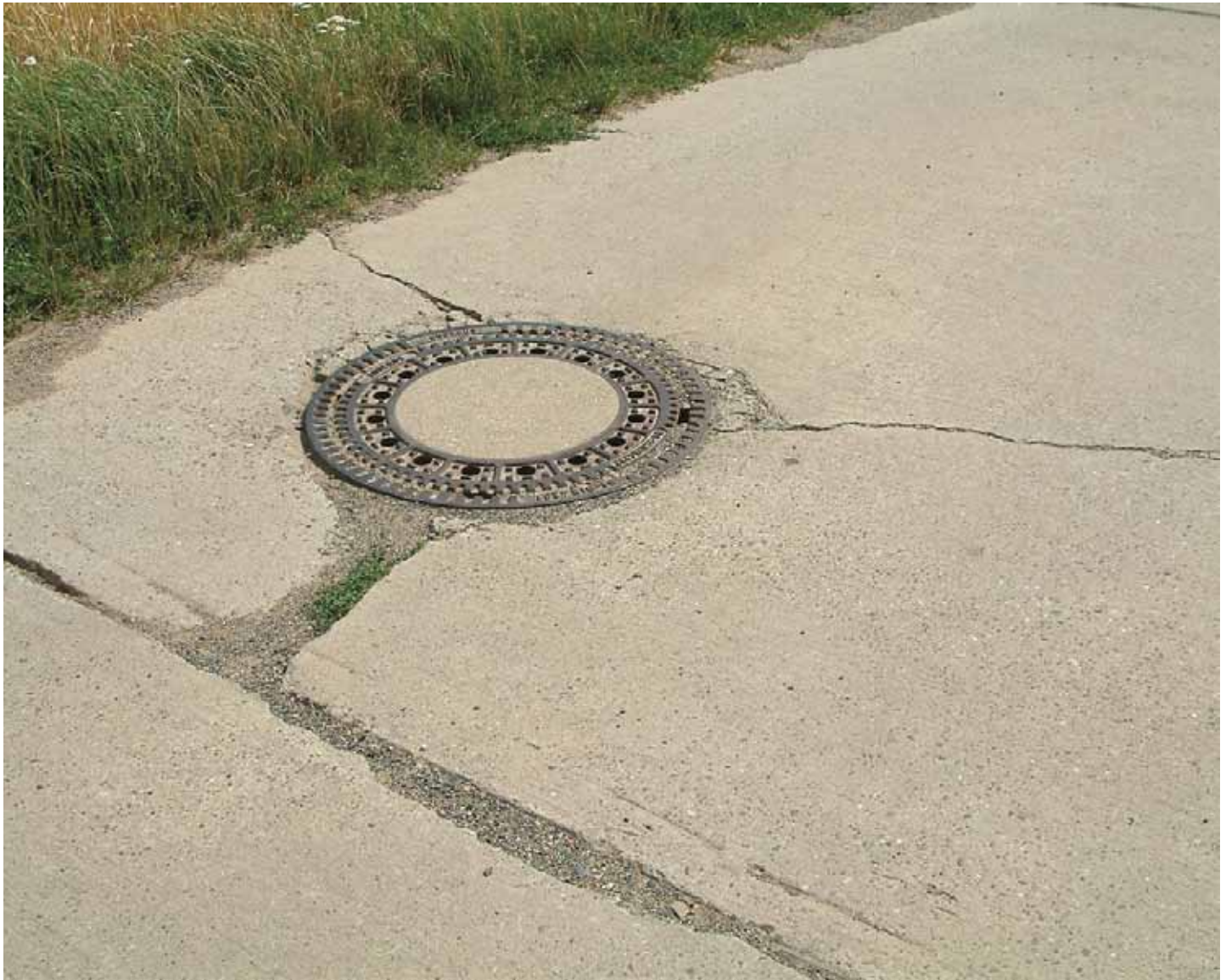
12 Risse infolge ungünstiger Lage der Quergefüge an einem Schacht
