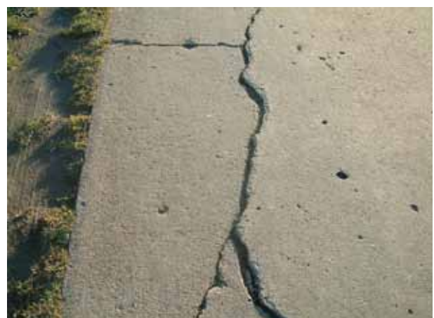
6 Risse am Plattenrand mit Absackung, Einschlüsse (Holz, Lehmknollen o.ä.)
