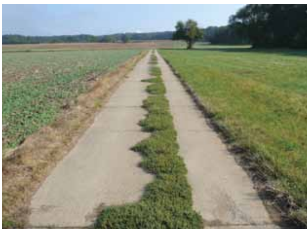
5 Längsrisse mit Pflanzenbewuchs
