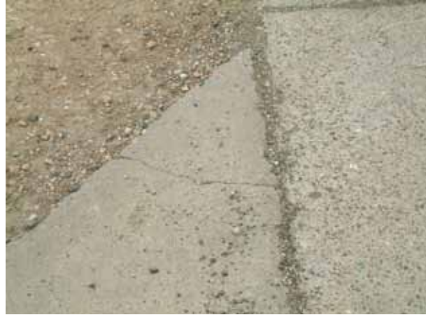
8 Riss an einem Zwickel
