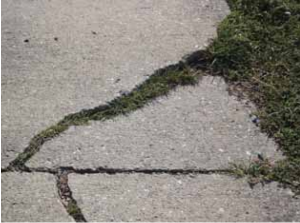
7 Eckabbruch mit Absackung
