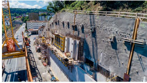
Fig. 6 Erstellung der Ort betonwand in Etappen. Construction of the in-situ concrete wall in stages. (© Emch+Berger WSB AG)
