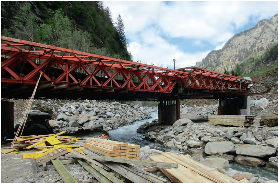
Fig. 7 Untenliegendes Lehrgerüst der Brücke Auriglia. Underslung falsework of Auriglia bridge.
