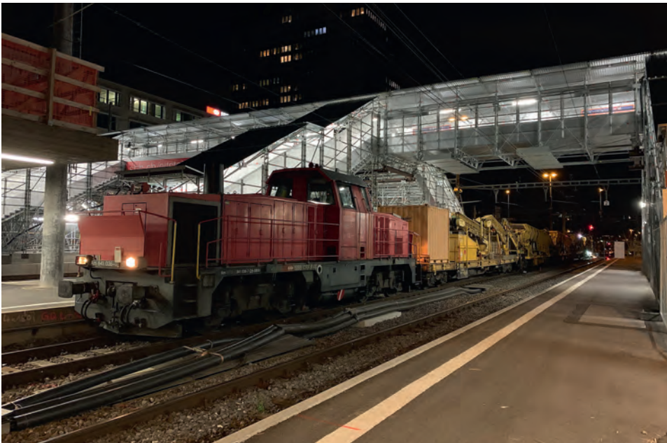
Fig. 2 Temporäre Passerelle als Zugang zu den Mittelperrons während der Bauzeit. Temporary walkway as access to the central platforms during the construction period.
