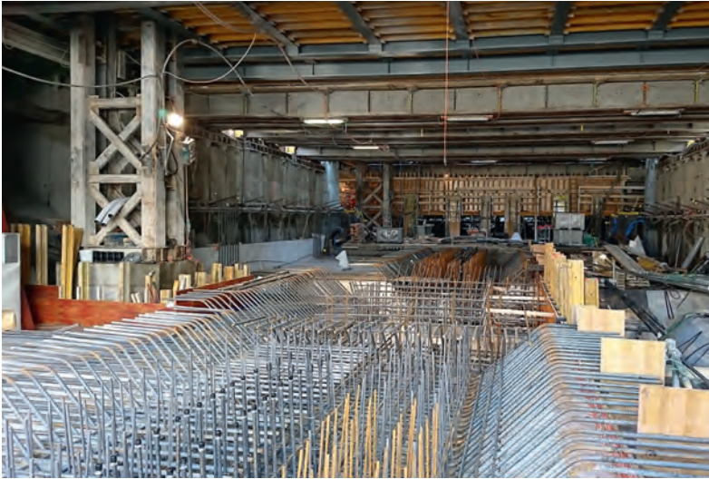
Fig. 8 Armierung der Bodenplatte unter den Gleis- und Perronhilfsbrücken. Reinforcement of the bottom slab under the auxiliary track and platform bridges.
