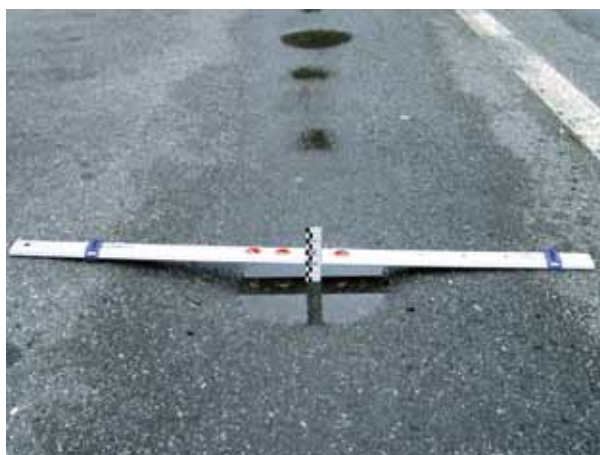
Route goudronnée avec déformation/orniérage
