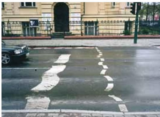
Déformations au niveau d'une signalisation
