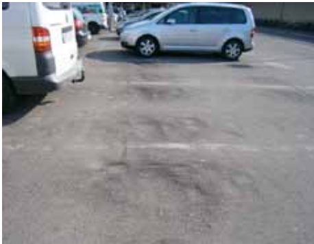
Écrasements, déformations localisées
