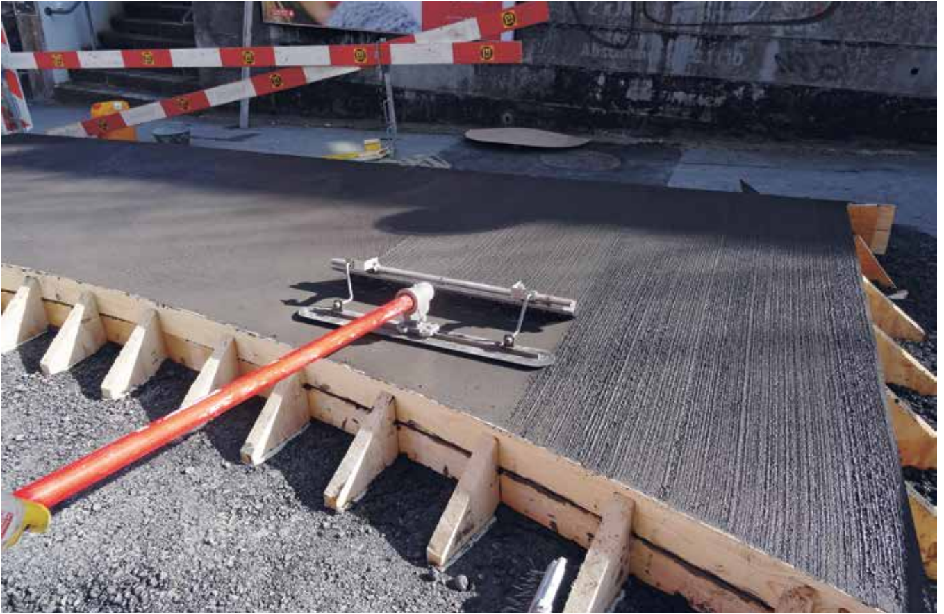
Aufräumen der Oberfläche mit dem Besen (oben) und Verkehrsinsel mit geklebten Randabschlusssteinen (rechts).
